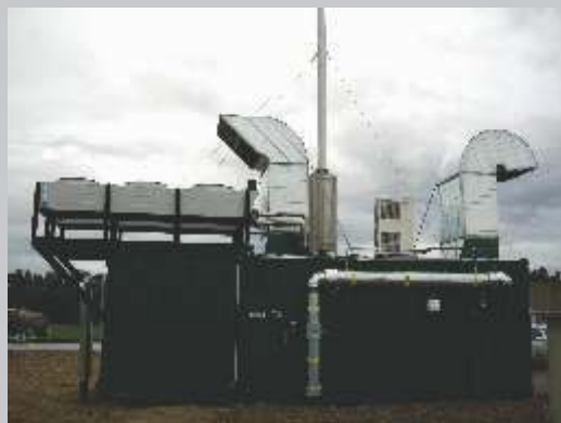
Echipament pe biogaz în container
